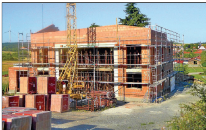
Der Rohbau ist bereits fertig gestellt. Schon bald sollen Dach, Fenster und Heizung folgen. Später werden hier einmal japanische oder skandinavische Gartenbereiche, ein Felsengarten, ein Waldbad, ein Teehaus und vieles mehr zu bewundern sein.
