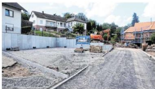
Der Weg zum neuen Kirchplatz von St. Wendelinus in Rauenberg ist bis auf die Deckschicht fertiggestellt.
