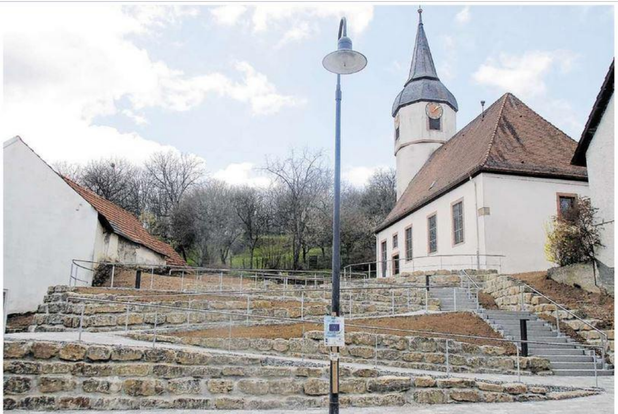
Der Aufgang zur evangelischen Kirche in Bofsheim wurde barrierefrei gestaltet. Nun soll dort auch ein behindertengerechtes WC gebaut werden.
